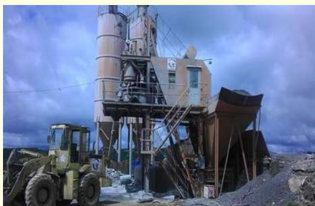
TRẠM TRỘN BÊ TÔNG
